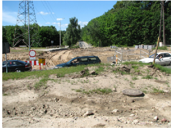
Zamknięty wjazd w ul. Leśną
